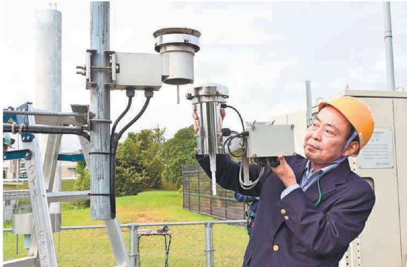
線状降水帯の予測向上に伴い、新たに湿度計を取り付ける日立アメダス。日立市会瀬町
